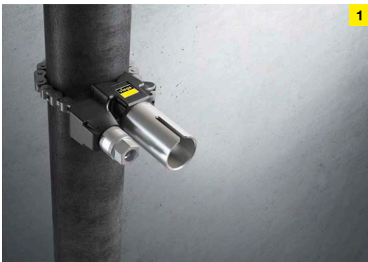
1. Na rurze stalowej mocuje się specjalną prowadnicę wiertarską do prowadzenia wrzeciona wiertarskiego.
